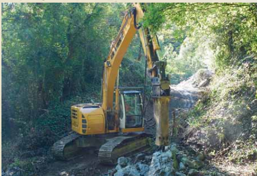
Les travaux de destruction du seuil de la Randonnière sur la Brévenne (Brussieu-Courzieu)
